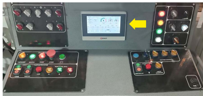
Данные о работе генератора выводятся на панель оператора
